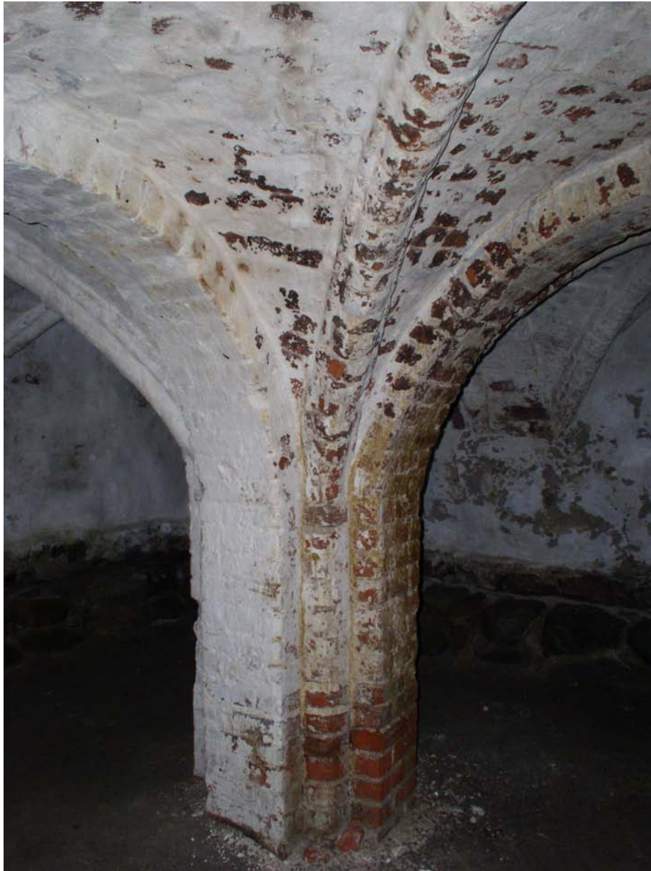
Källaren med fuktiga svicklar.
