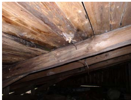
Rötskador i södra takfallet.
